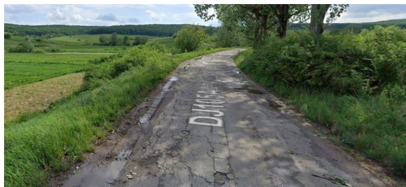
Fig. 3.3: Starea de degradare a carosabilului pe proba PS2 Raliul Brașovului 2021.
